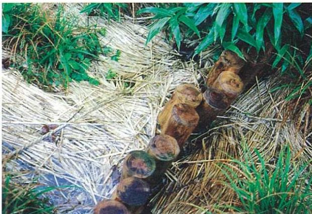
写真9-2 雨水やわら、土砂が溜まっている 丸太杭土留工（1999年8月）
