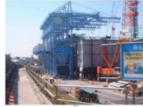
AB キャリア 高気圧作業室と地上間で使用する専用の揚重設備
