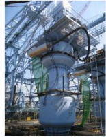
マテリアルロック 高気圧作業室と地上間で資材、掘削土砂の出入りに使用する設備
