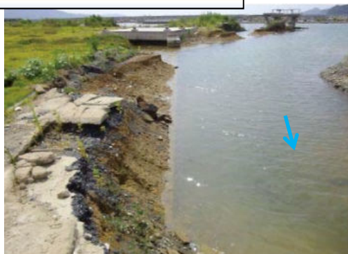
被災後の状況 (しおさい橋～松原大橋間)
