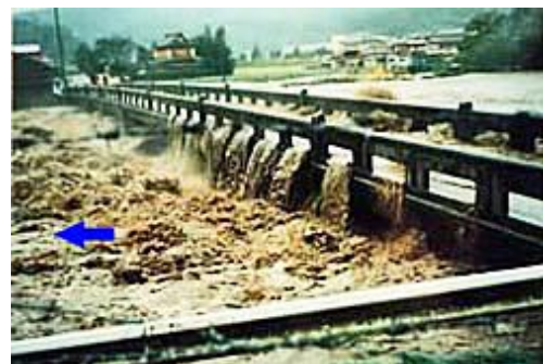
被害状況：昭和橋
