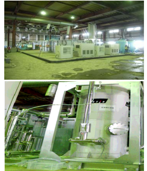
図:新設処理施設 (上:施設全体、下:促進酸化装置)
