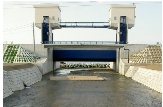
水門 門を閉めることで津波が川に沿って 浸入するのを防ぐ
