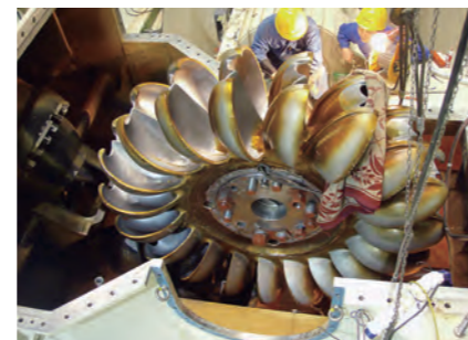
ペルトン水車（松川発電所）
