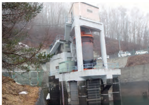
【写真】岩洞取水口
