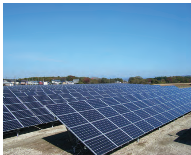
太陽電池モジュール
