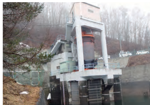
【写真】岩洞取水口
