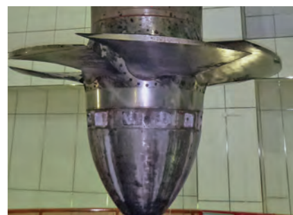
カプラン水車（四十四田発電所）
