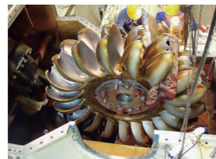
ペルトン水車（松川発電所）
