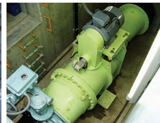
北ノ又第三発電所 水車発電機
