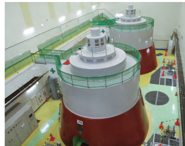
岩洞第一発電所・発電機
