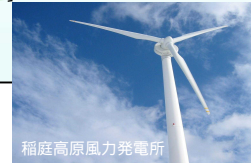
稲庭高原風力発電所
