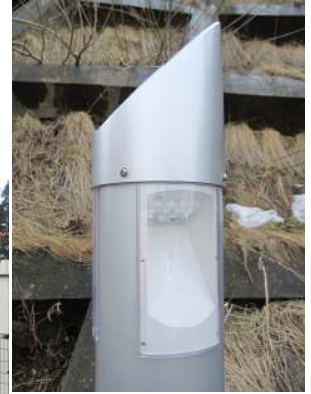
←野田村太陽光発電式防災・防犯用照明設置事業 (H24)
