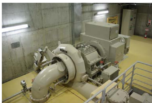
胆沢第三発電所の水車発電機 (1,600kW、H26.7 運転開始)
