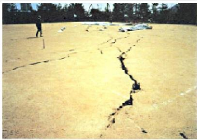
幅が15cm以上と変状の程度が大きいクラック(ひび割れ)
