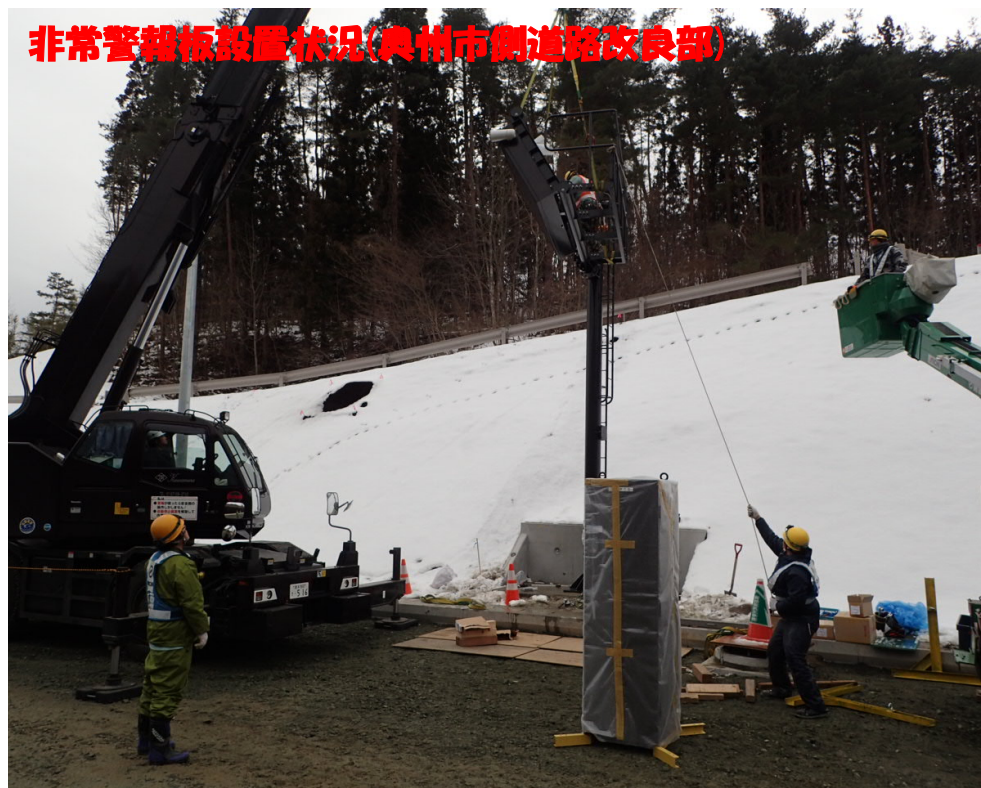
照明設置状況(トンネル部)
