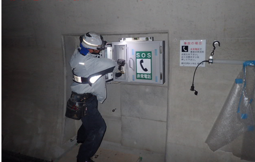
非常電話設置状況(トンネル部)
