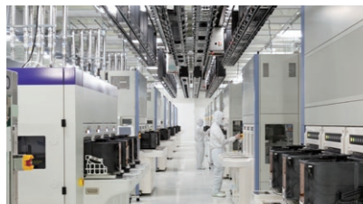
自動化された先端クリーンルーム
