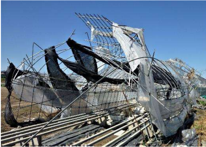
台風被害の様子
