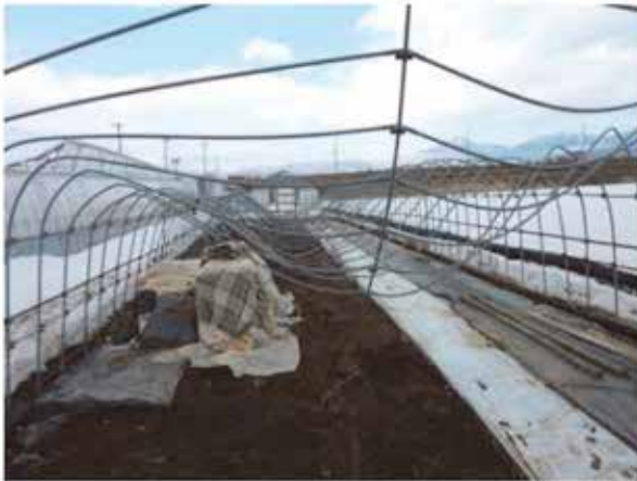
単棟パイプハウスのM字型陥没
