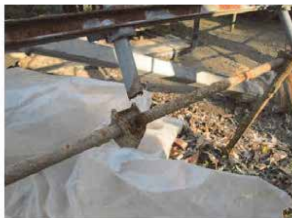
地際部の腐食による折れ
