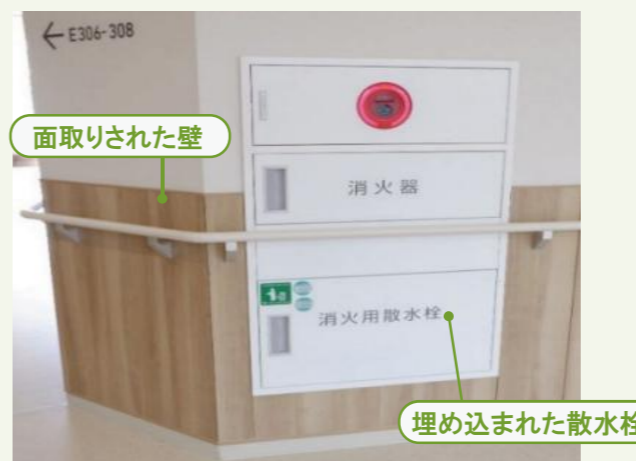
壁面に埋め込まれた消火器と散水栓
