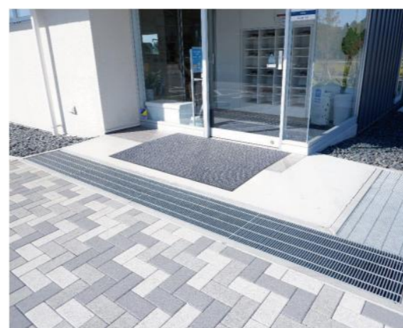
車いすのキャスターや杖が溝に落ちない配慮 段差がなく、隙間が細かい蓋を使った排水溝。
