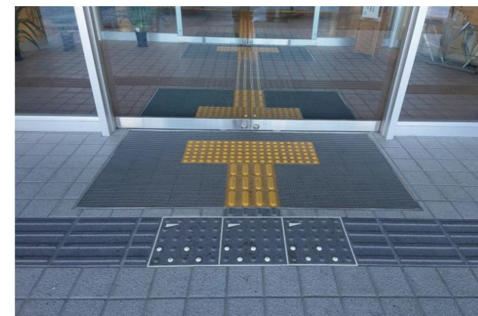
▲自動式引き戸の出入口を知らせる点状ブロック
