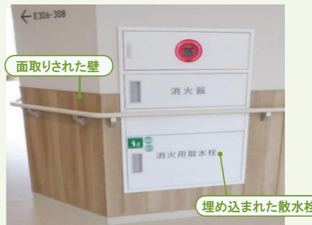
壁面に埋め込まれた消火器と散水栓
