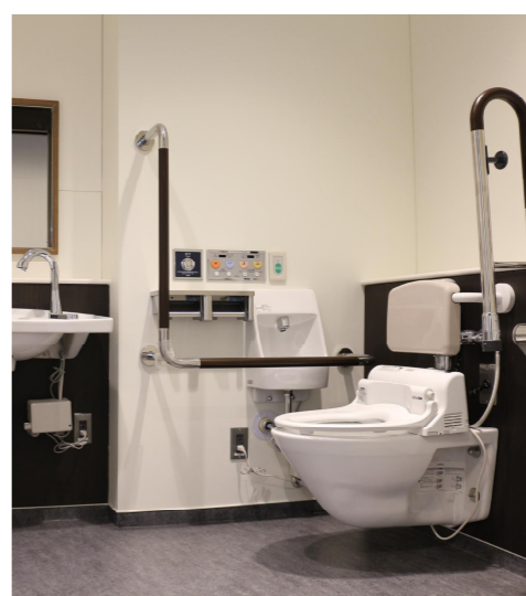
▲設備や手すりや壁との間に色のコントラストをつけることで、手すりの視認性を高めている。
