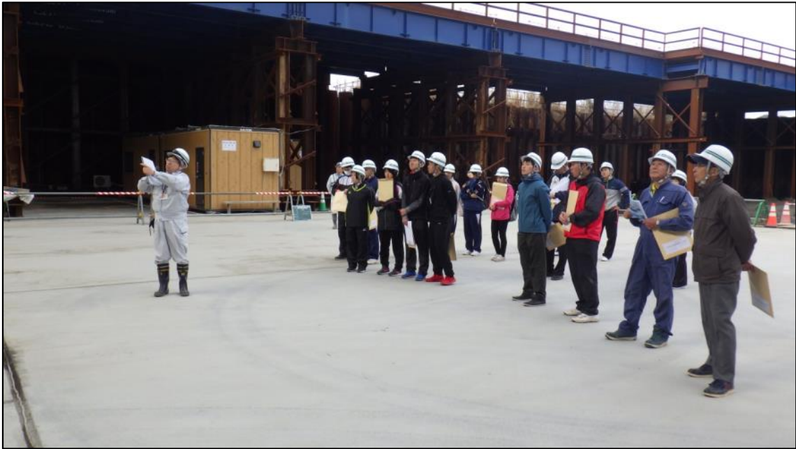
設備工事の説明
