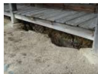
写真:文化財被害の状況
