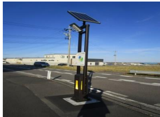
クリーンエネルギー導入支援事業により設置を支援したソーラー街灯 (ひろの水産会館)
