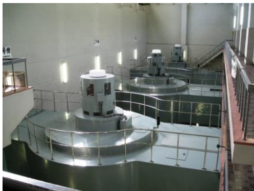
仙人発電所（奥側2機が仙人発電所）
