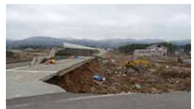
被災の状況(平成23年3月15日)
