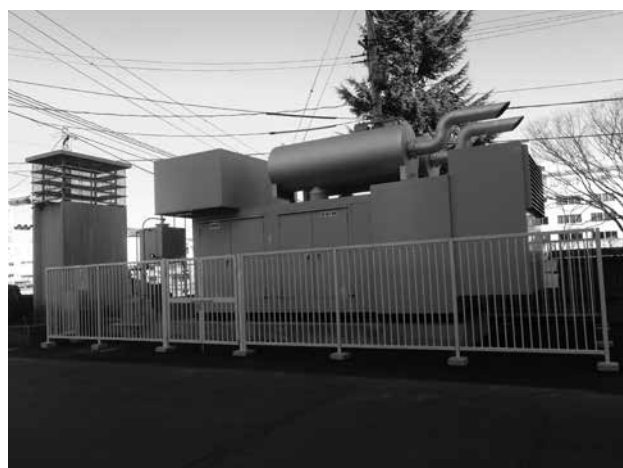
盛岡地区合同庁舎非常用発電設備更新(平成25(2013)年度整備完了)
