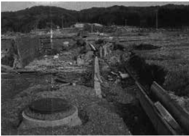
配水管損壊(大槌町)
