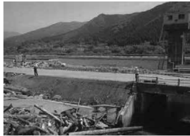
添架管損壊(大船渡市)
