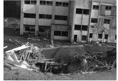
鵜住居第2取水ポンプ場(釜石市)
