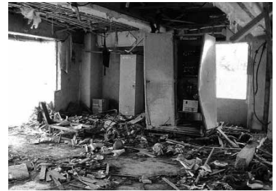
中央制御室損壊(陸前高田市)
