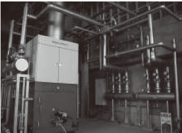
普代村 くらさき荘(チップボイラー)
