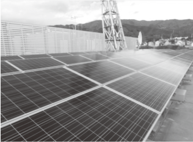
陸前高田市 消防署(太陽光+蓄電池)
