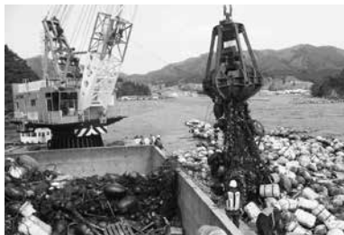
漁船・漁具や養殖施設等の回収及びがれき等の撤去作業
