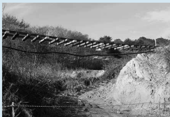
令和元(2019)年10月に発生した台風19号での被害状況
