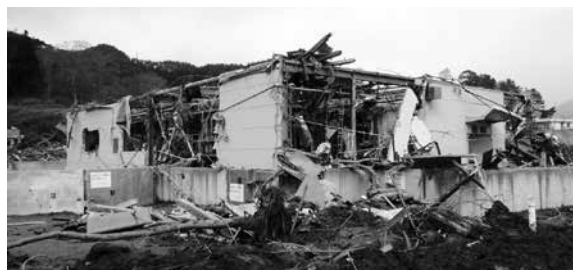
津波により被災を受けた通信ビル
