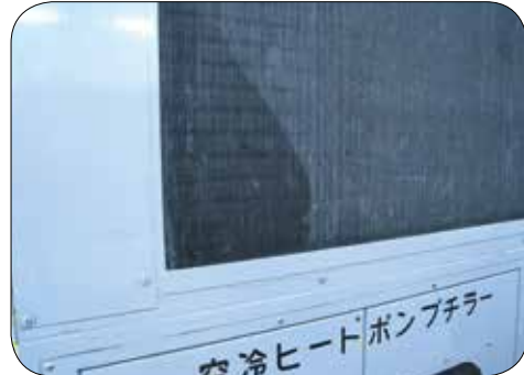
熱交換器の油のにじみ
