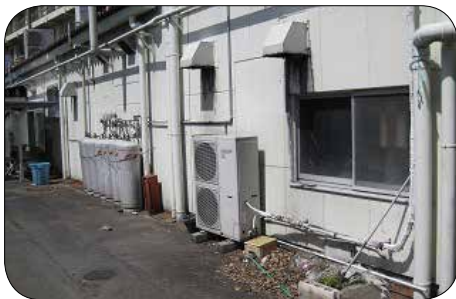
室外環境異常による配管の劣化
