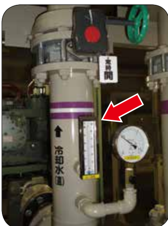
写真-F 冷却水出口温度
