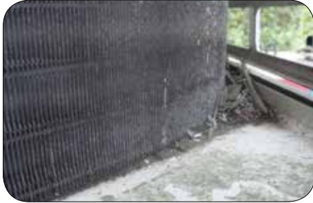
熱交換器下部の腐食
