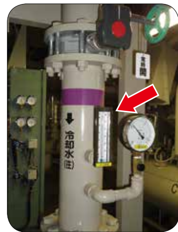
写真-E 冷却水入口温度
