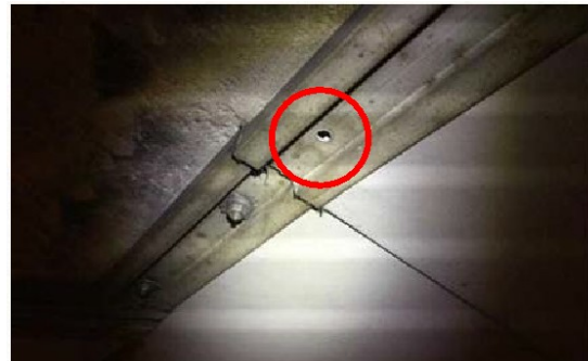
付写真-1.10 導水樋の止め金具が脱落した例
