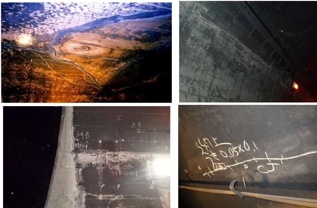
付写真-1.12 コールドジョイント付近に発生したひび割れの例
