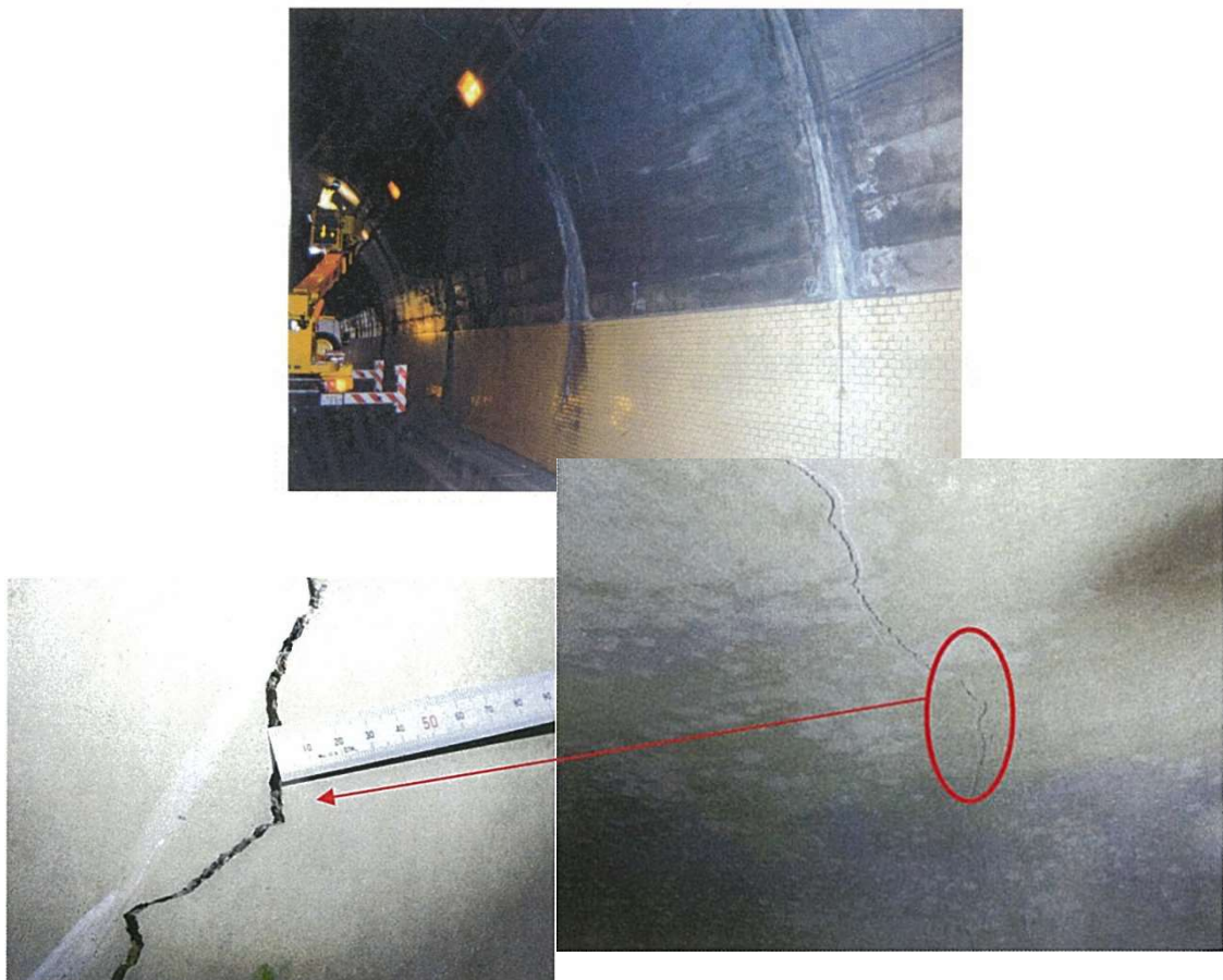
付写真-1.4 覆工スパンの中間付近に発生したひび割れの例
