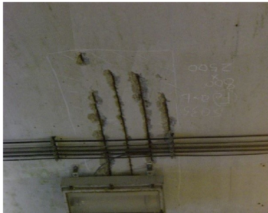
付写真- 2.2 鋼材腐食の例
