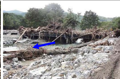
⑥安家橋の流木閉塞状況
