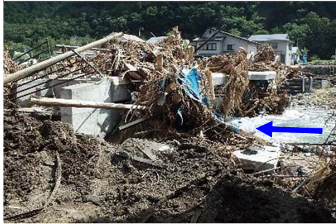
①中の橋の流木閉塞状況
