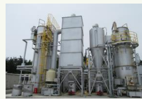
久慈バイオマスエネルギー
