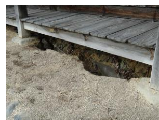
写真：文化財被害の状況
