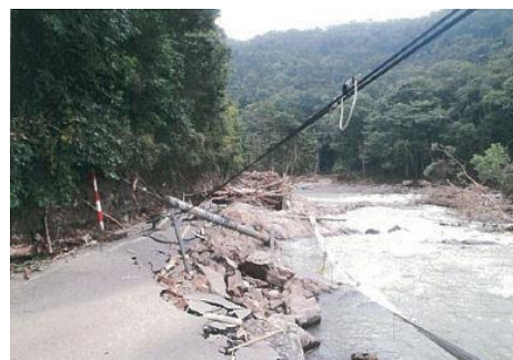
写真：台風10号による道路被害の状況（岩泉町）
