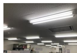
事務所内のLED照明
