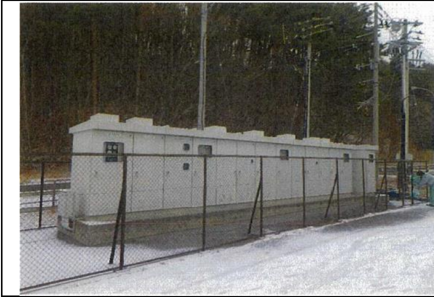
高圧受配電設備 (屋外キュービクル) 既設盤筐体は再利用
