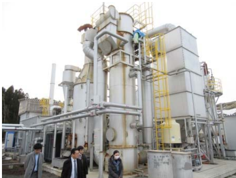
木質バイオマスボイラー
