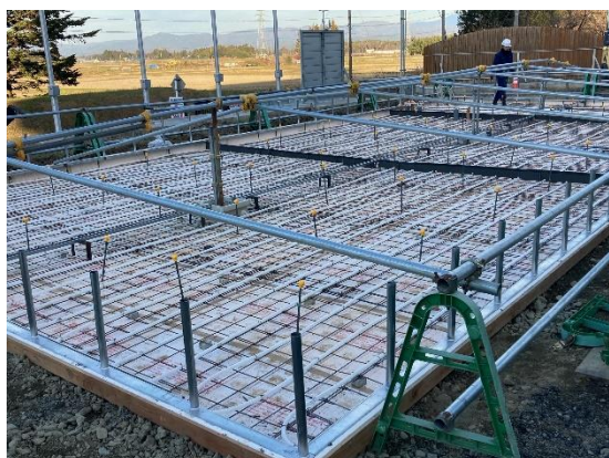
温水を循環させる床暖房設備
