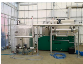
チップボイラー
