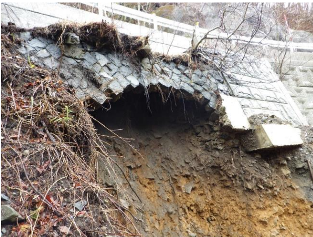
崩落状況(R2年4月時点)
