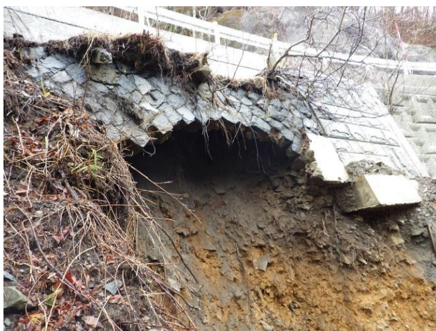
崩落状況(R2年4月時点)
