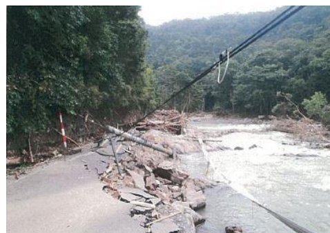
写真：平成28年台風第10号による道路被害の状況
