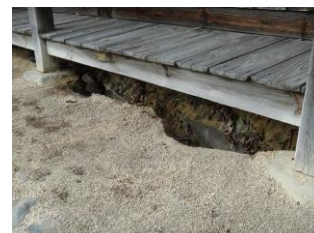
写真:文化財被害の状況
