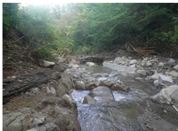
林道の路体流出(普代村)
