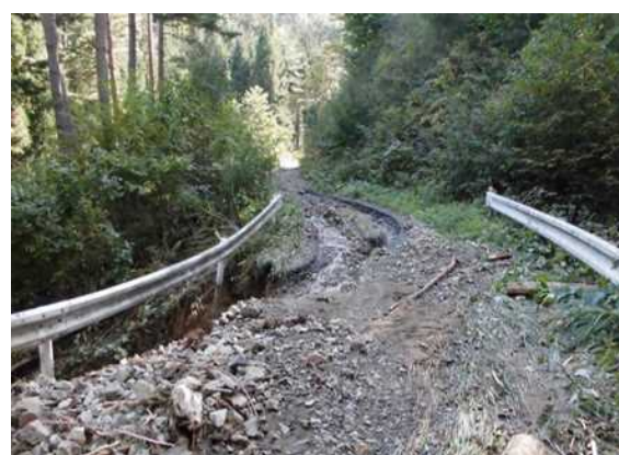
林道の路肩決壊(岩泉町)
