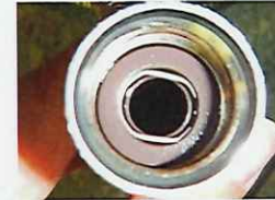
【ホースの接続部】 ぬめりが付着 ゴムパッキンが歪んでいる
