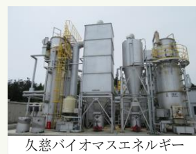
久慈バイオマスエネルギー
