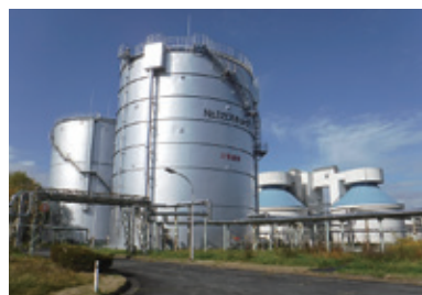
ガスタンク(左)と汚泥消化タンク(右)
