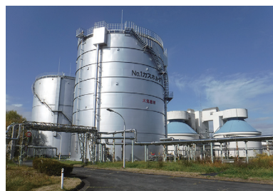
ガスタンク(左)と汚泥消化タンク(右)
