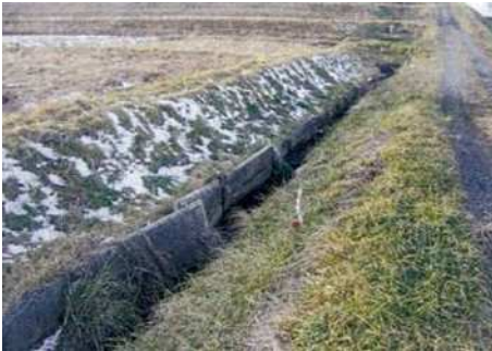
排水路の崩落
