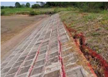
堤体法面の滑り、堤体の亀裂
