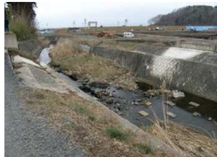
被災状況 (H23.12)
