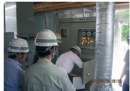
操作盤点検（下荒川海岸堤防）
