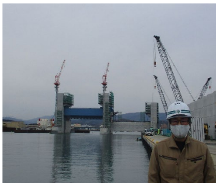
▲開伊川水門の工事を担当 (現所属：沿岸広域振興局土木部宮古土木センター復興まちづくり課)
