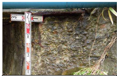
【損傷内容】広範囲の剥離・鉄筋露出
