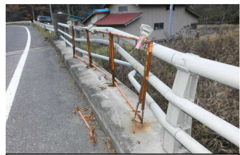
【損傷内容】防護柵の変形
