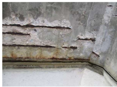
【剥離・鉄筋露出_e】の例
