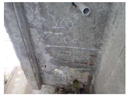
【剥離・鉄筋露出_d】の例
