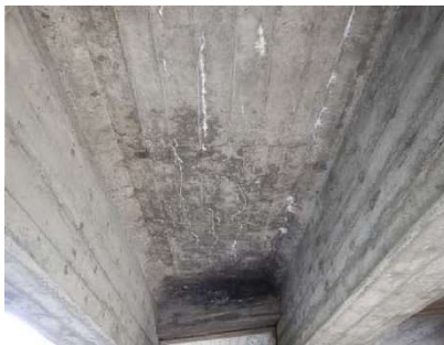
【床版ひびわれ_d】の例
