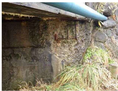
【剥離・鉄筋露出_e】の例
