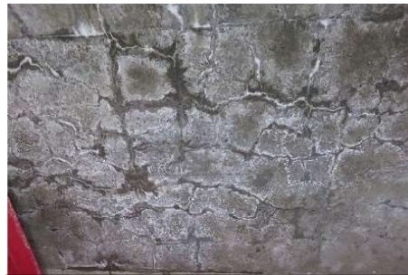
【損傷内容】格子状ひびわれ
