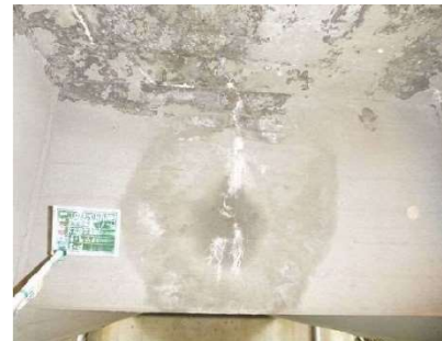
【漏水・遊離石灰_d】の例
