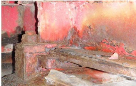
【損傷内容】板厚減少を伴う腐食
