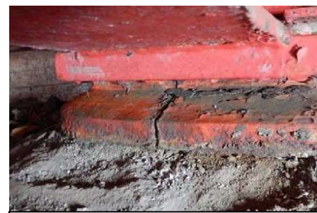
【損傷内容】下沓の亀裂
