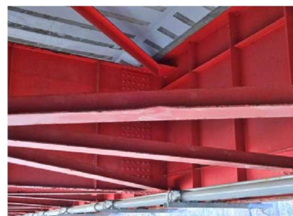
【変形・欠損_e】の例
