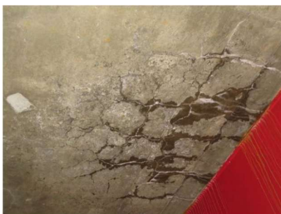
【床版ひびわれ_e】の例
