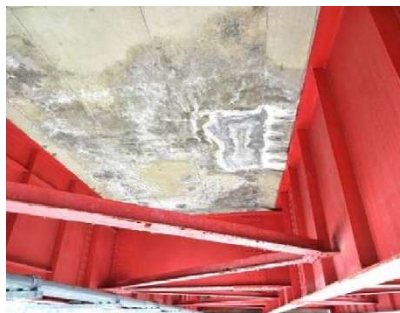
【漏水・遊離石灰_e】の例
