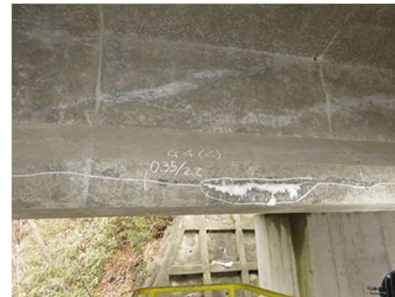
【漏水・遊離石灰_d】の例
