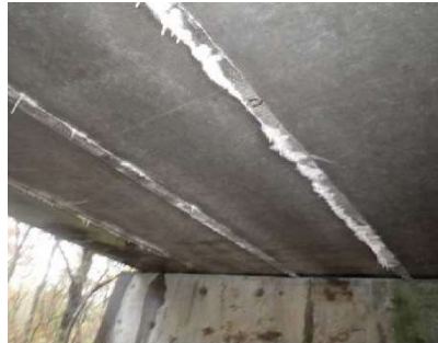
【漏水・遊離石灰_d】の例
