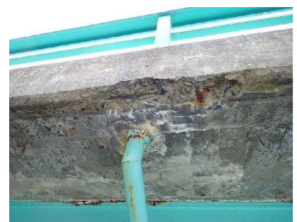
【剥離・鉄筋露出_e】の例
