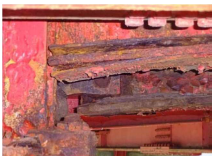
【腐食_e】の例
