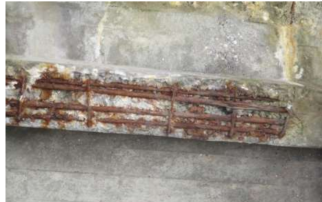
【損傷内容】断面減少を伴う鉄筋露出
