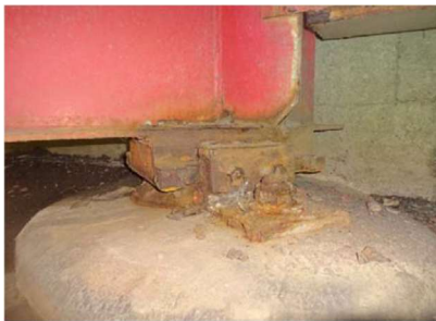
【腐食_e】の例
