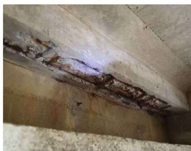
【剥離・鉄筋露出_e】の例
