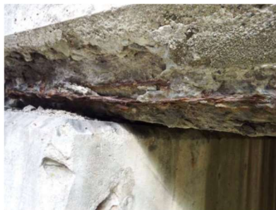
【剥離・鉄筋露出_e】の例
