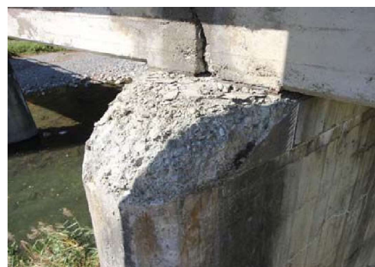
凍害による損傷事例(橋脚部)
