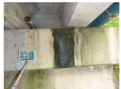
【漏水・滞水_e】の例
