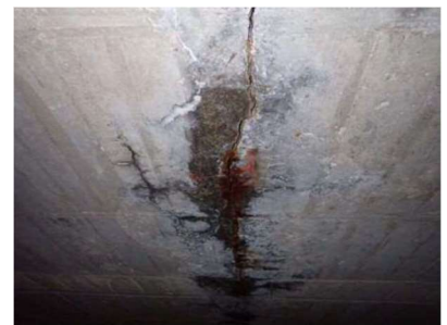
【漏水・遊離石灰_e】の例
