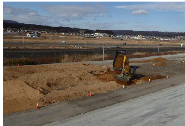
写真－2 締固めない盛土（バックホウ後退施工（重機上載最少施工））
