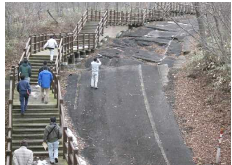
平成27年12月15日 岩手宮城内陸地震遺構（一関市）
