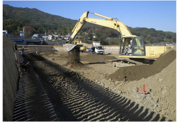
写真－1 植栽面の耕起（スケルトンバケットによる石礫除去）
