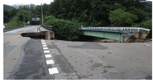
箱石達曾部道路に並行する国道106号で発生した道路流出 (平成28年8月 台風第10号)
